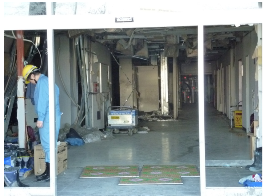
タービン建屋1階部の浸水(現在解消) (電気・機械設備)
