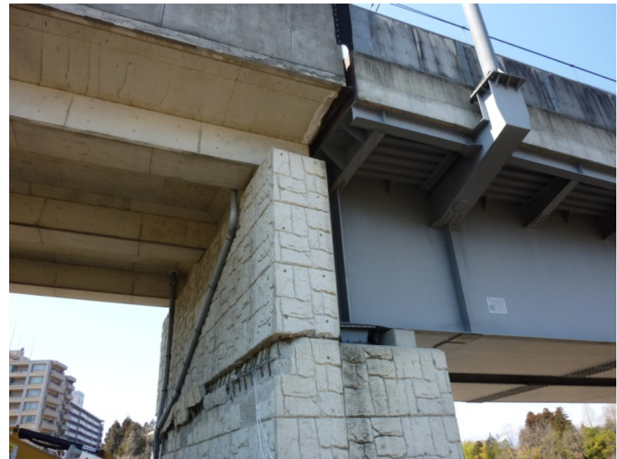
泉中央駅～黒松駅間の 高架橋の損傷
