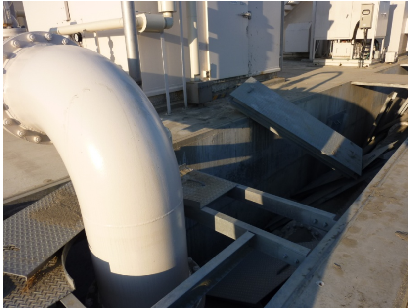
タービン建屋1階部の損傷
