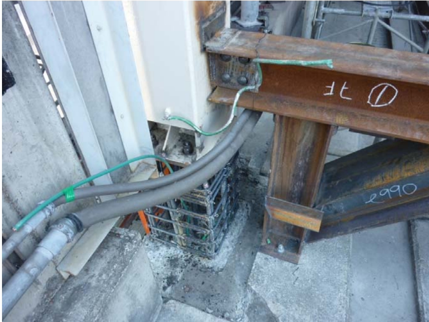
八乙女駅上屋鉄骨の アンカーボルト破断
