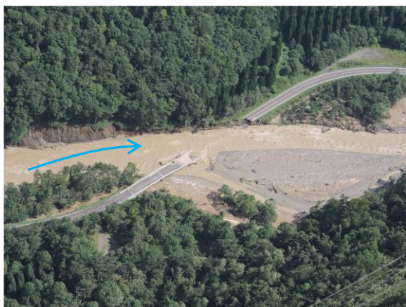
図 6.3.2.5 岩瀬橋の路盤流出
