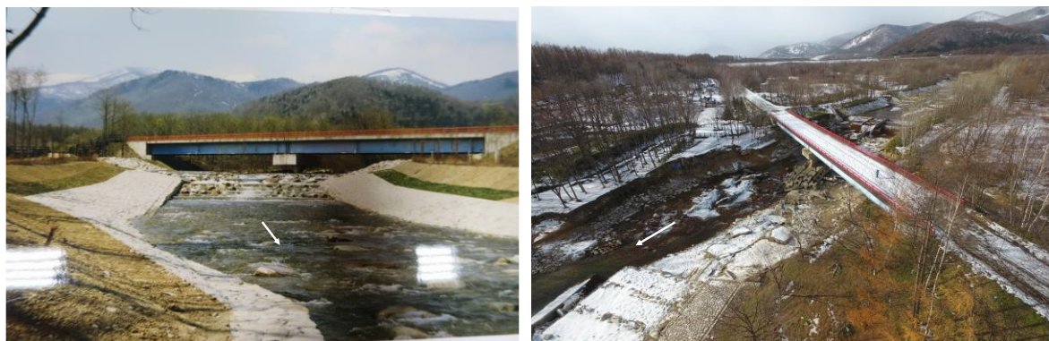
図 4.4.2 町道ペケレベツ川橋付近の被害状況、左) 北海道提供（整備直後の撮影、下流からペケレベツ川橋を望む）、右) 出水後（11/17 調査団撮影、左岸側からペケレベツ川橋を望む）
