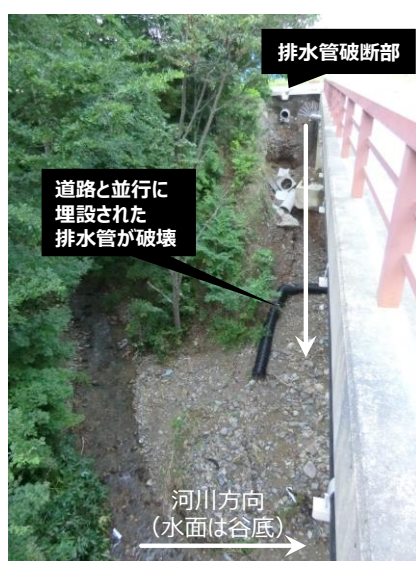
図 5.3.13 白花橋の被災状況 (橋上から撮影)
