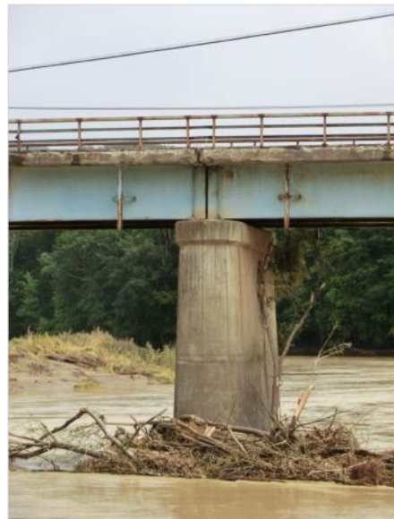
図 5.2.6 橋脚への流木の堆積状況
