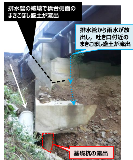
図 5.3.14 白花橋の被災状況 (左岸上流側から撮影)
