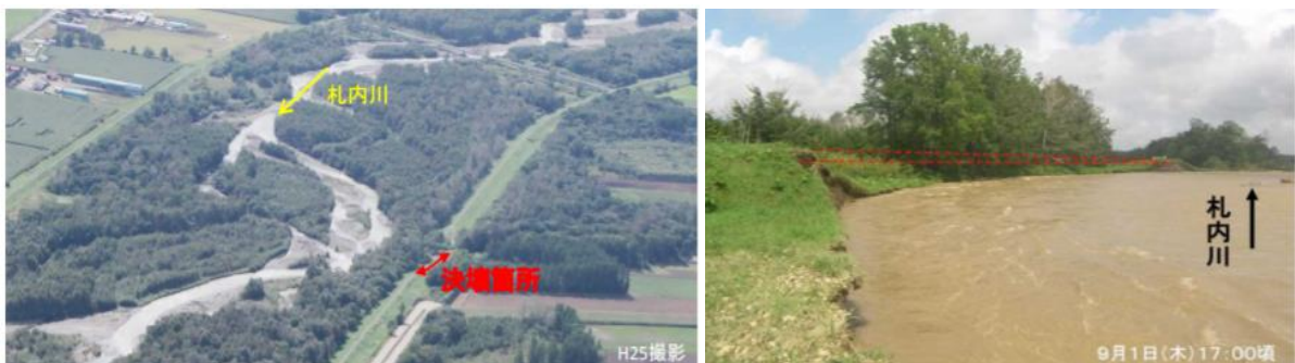
図 4.2.2 堤防決壊状況、左) 災害前 (開発局提供)、右) 決壊箇所の状況 (開発局提供)
