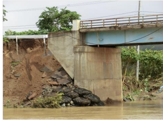
図 5.2.4 橋台背面盛土の流出状況
