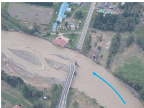
図 6.3.2.2 千呂露橋の落橋
