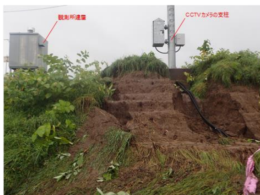
図 5.2.8 侵食箇所の全景
