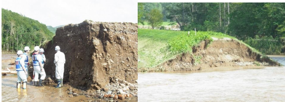
写真 3.3.5.1 破堤部の様子
