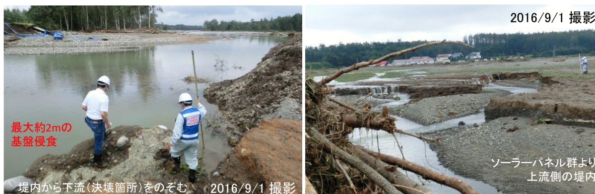
図 4.1.8 札内川左岸（戸蔦別川合流地点）堤防決壊箇所の被災状況（図 4.1.6 中の②）
