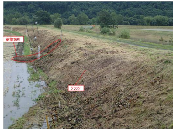
図 5. 2. 33 のり面中腹のクラックの状況
