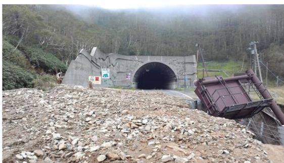
図 6.3.2.8 日勝トンネル出口の路盤流出
