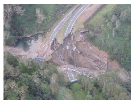
図 6.3.2.9 石山トンネル出口の路盤流出
