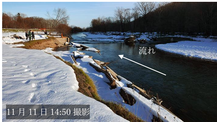
図 5.3.16 第2頭首工直上流の河岸侵食
