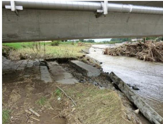
図 5.3.9 水郷大橋右岸橋台付近の護岸工の流出および変状
