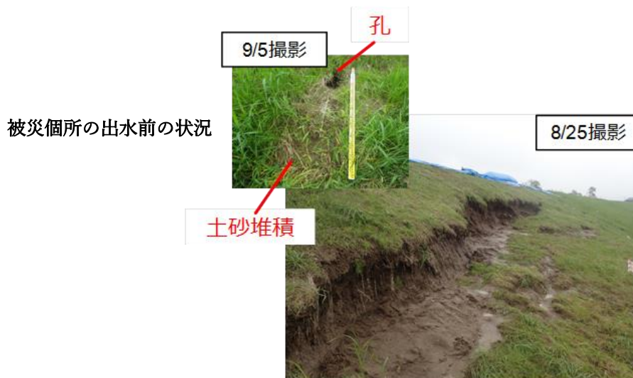
図 6.2.2.2 被災箇所の詳細状況
