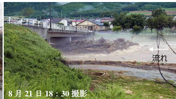
図 5.3.8 水郷大橋橋脚の流木と堰上げ
