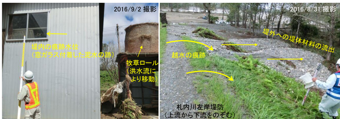
図 4.1.5 札内川左岸（戸蔦別川合流地点）堤防決壊箇所での痕跡調査
