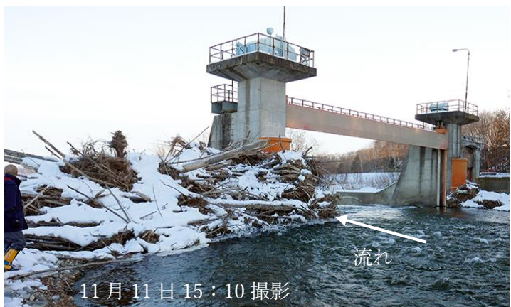
図 5.3.17 第1頭首工堰柱への流木の集積状況
