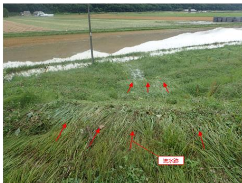
図 5.2.10 侵食崩壊が発生していない箇所の状況
