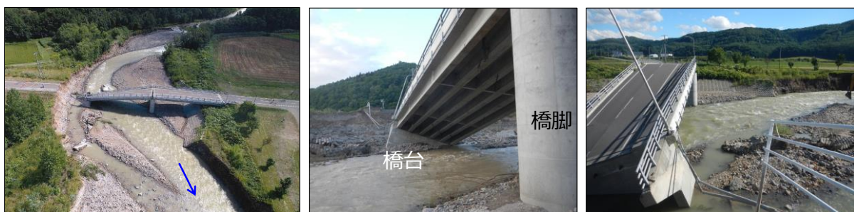
図 3.2.3 九線橋の被災状況 (提供: 寒地土木研究所)
