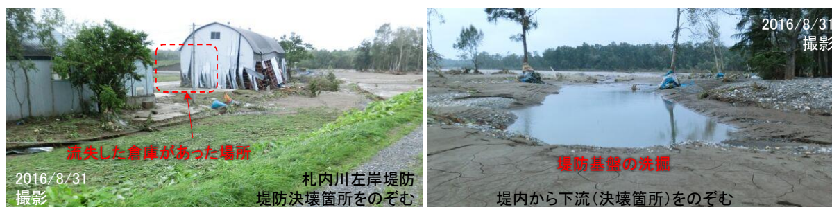
図 4.1.7 札内川左岸（戸蔦別川合流地点）堤防決壊箇所の被災状況（図 4.1.6 中の①）
