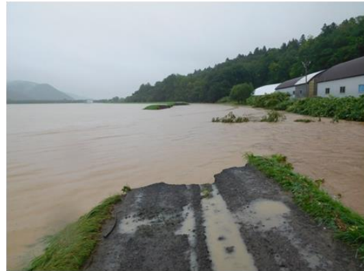
図 5.2.15 堤体の流出状況②
