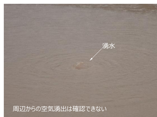
図 5.2.25 堤内地盤からの湧水の発生状況
