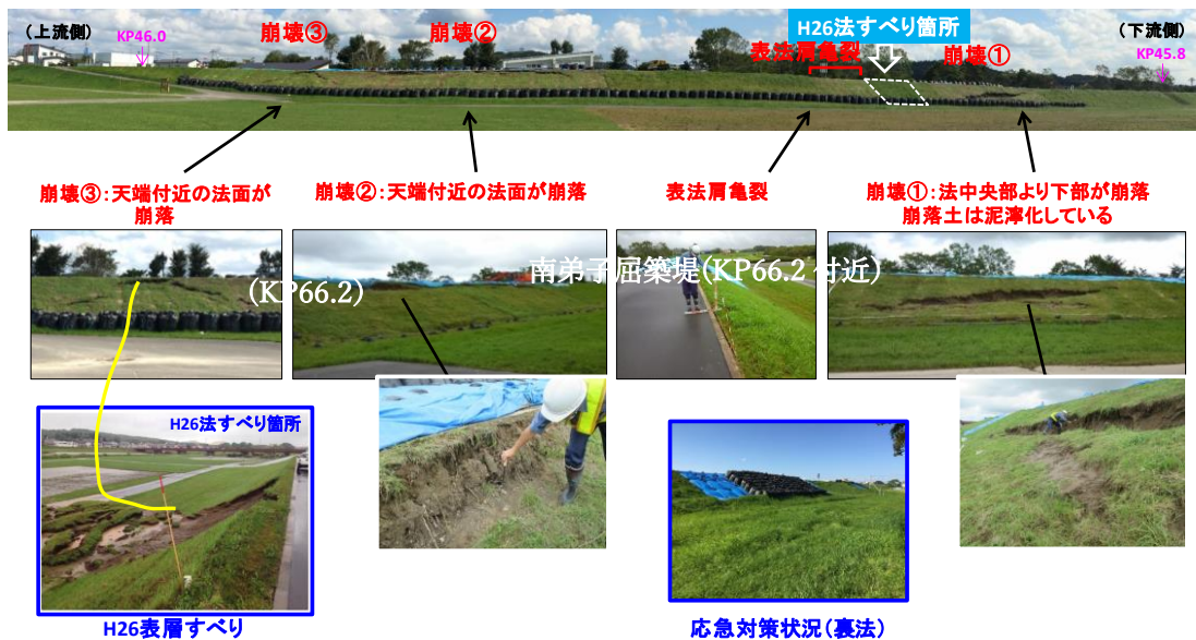
図 6.2.2.1 被災状況のまとめ
