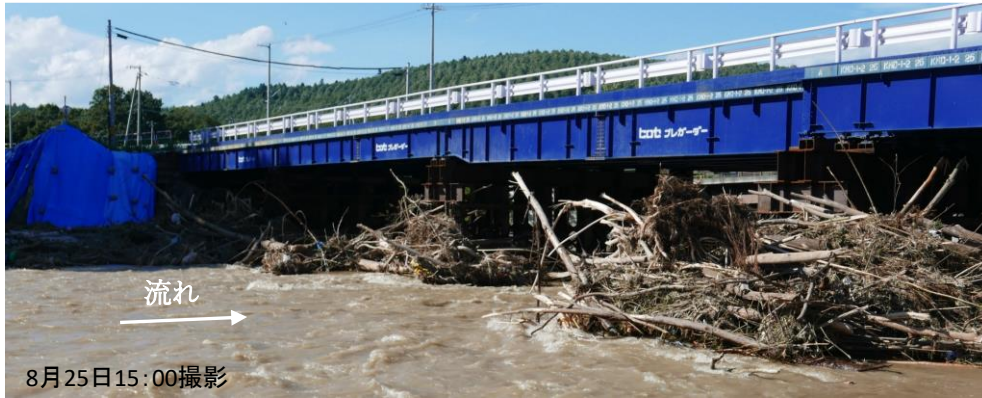
図 5.3.4 清見橋（仮設橋）の流木の集積状況
