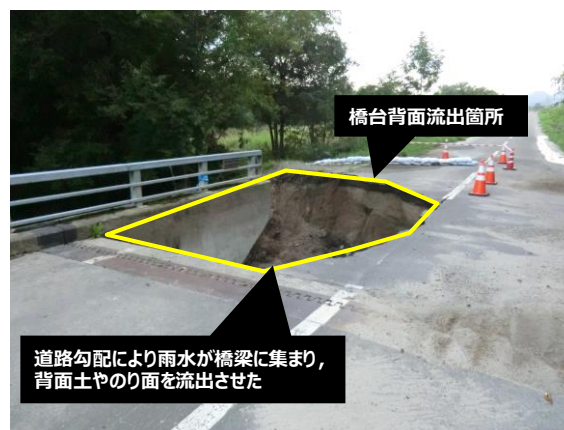
図 5.3.12 川上橋の被災状況（右岸側）
