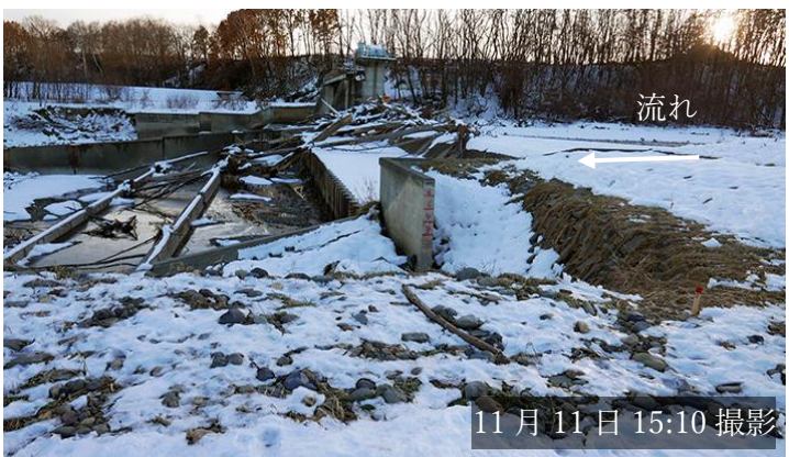
図 5.3.18 第1頭首工左岸高水敷の洗掘状況
