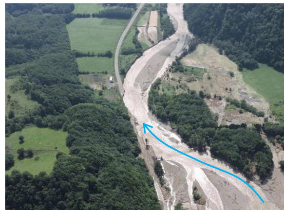
図 6.3.2.3 国道路盤の流出
