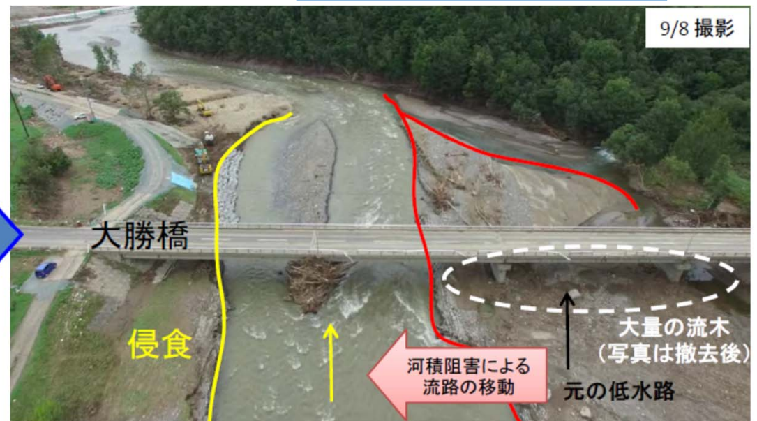
被災後の状況(流木による河積阻害の影響で流路が左岸に移動したと推察)
