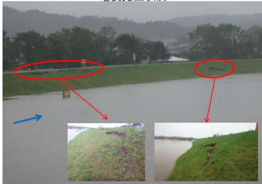
亀裂発生状況
