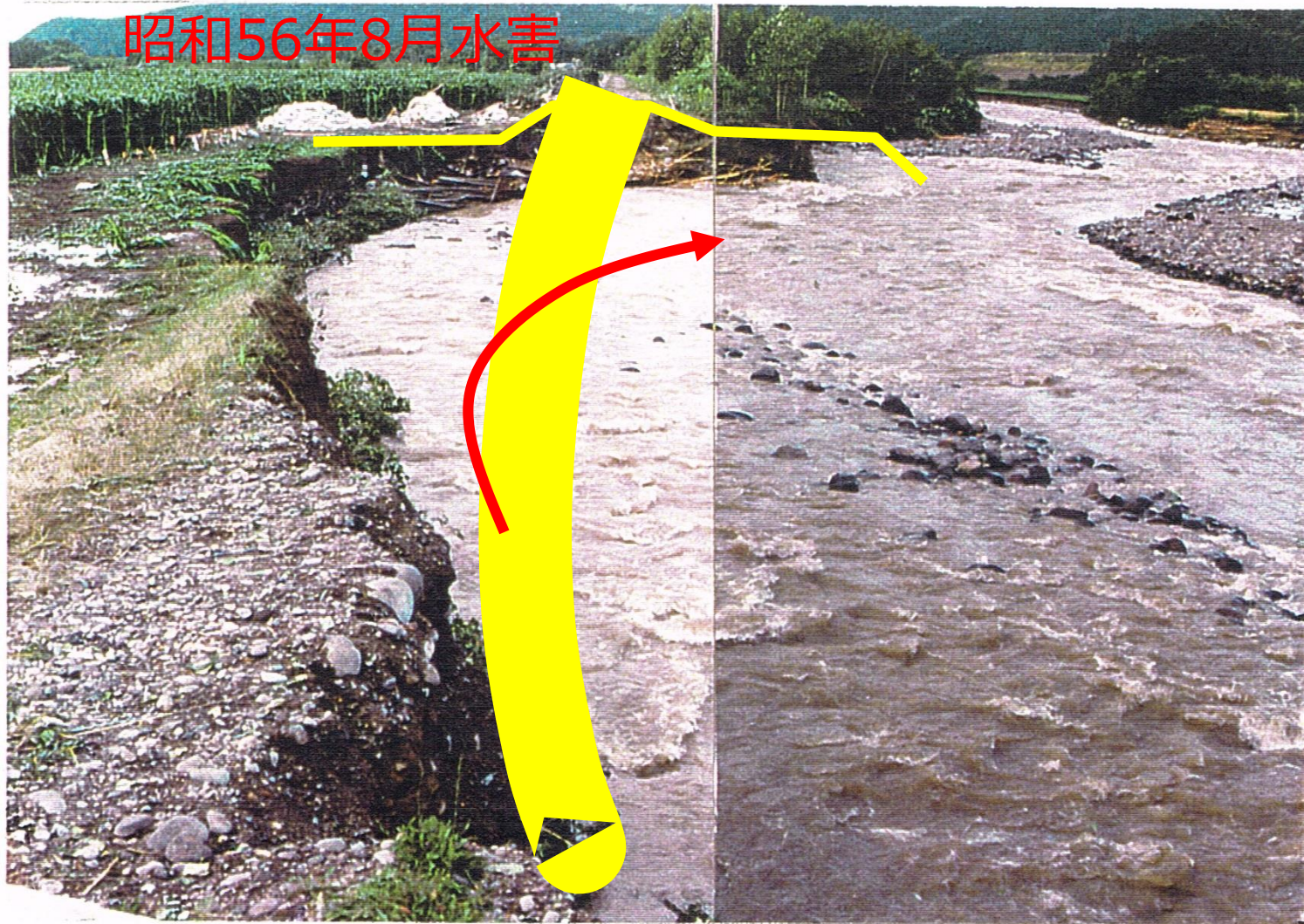
S56. 8. 6 正午 美瑛川 美沢19線美沢左岸築堤被災状況 被災延長 150M
