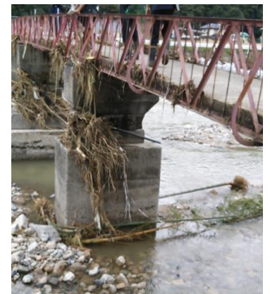
根谷川の橋梁での痕跡
