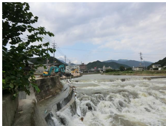
根谷川での護岸の崩壊
