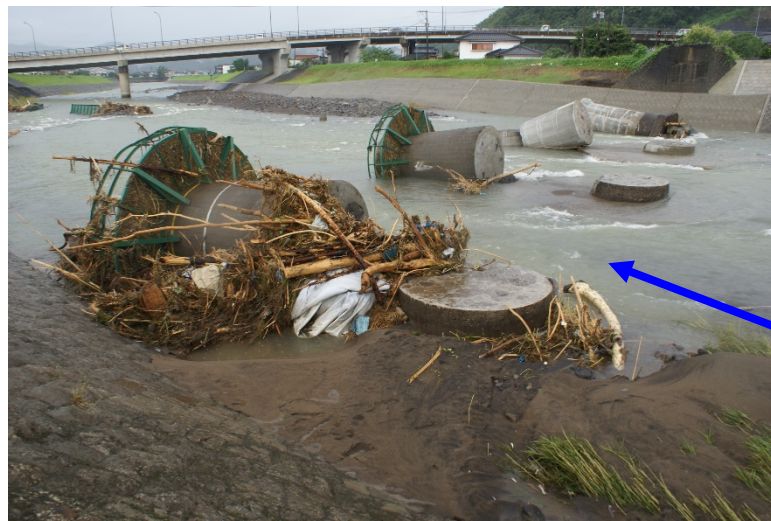
折れた橋脚(4基)
