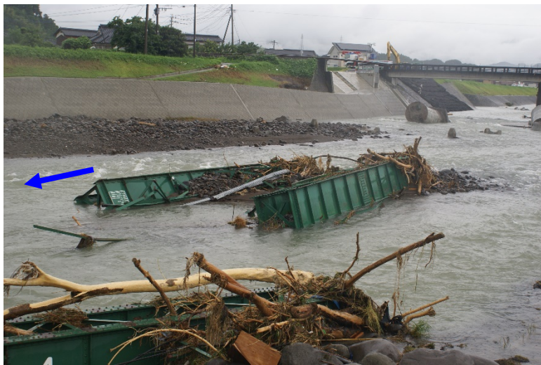
河道に落下している橋桁部
