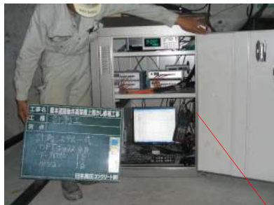
↑機器収納箱内の様子
