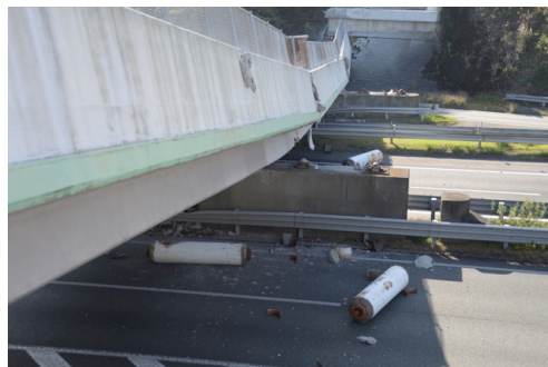
写真 1 九州自動車道上に落橋した府領跨道橋
