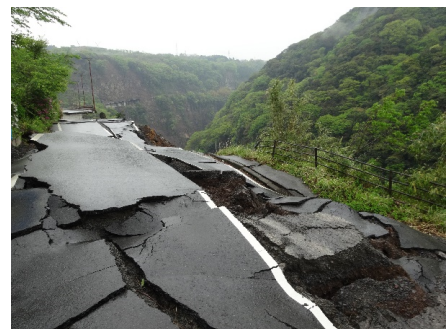
写真 5 阿蘇長陽大橋に取り付く道路の損壊・崩落
