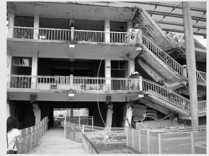
写真-5 921 地震教育園區 校舎崩壊現場
