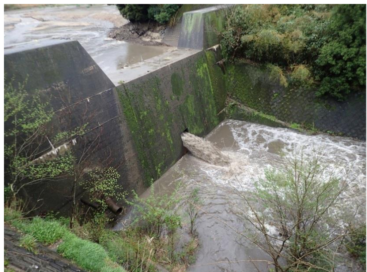
図-2 堰堤放水口から排出される濁水
