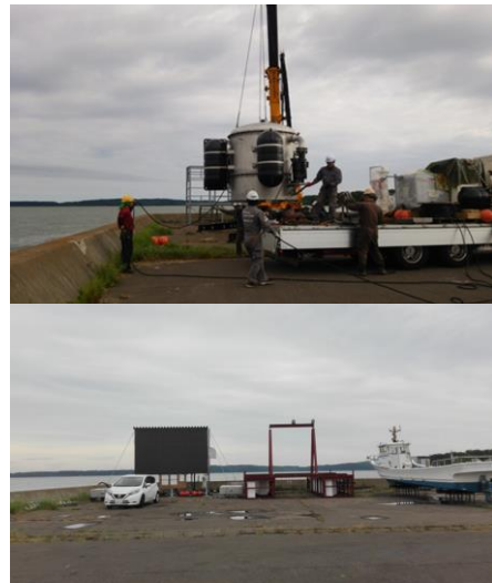
図 2 試験プラントの外観
