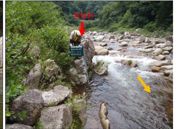
5.46km地点の水位計設置状況
