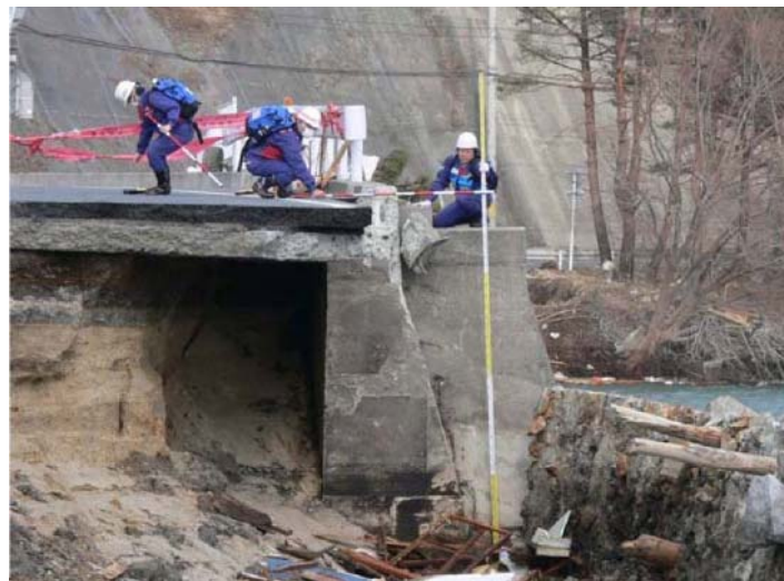
▲国道45号の被災状況調査(近畿地方整備局TEC-FORCE)
