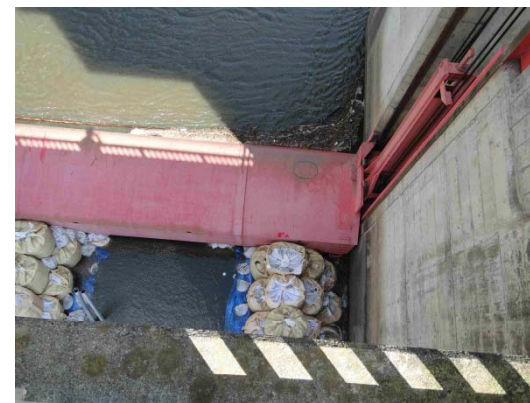
ゲート下流での漏水
