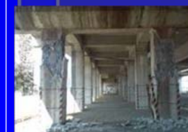
B2(損傷レベル3)
