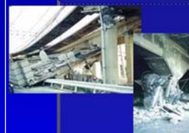
A(損傷レベル4)
