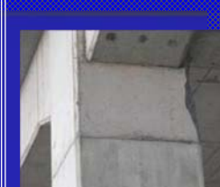
C(損傷レベル2)
