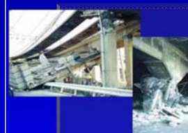
A(損傷レベル4)
