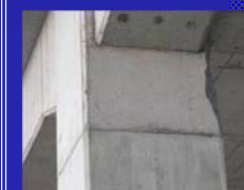
C(損傷レベル2)
