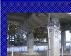
B1(損傷レベル3)
