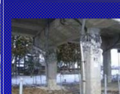
B1(損傷レベル3)
