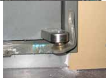
1/50: 扉取付け部変形
