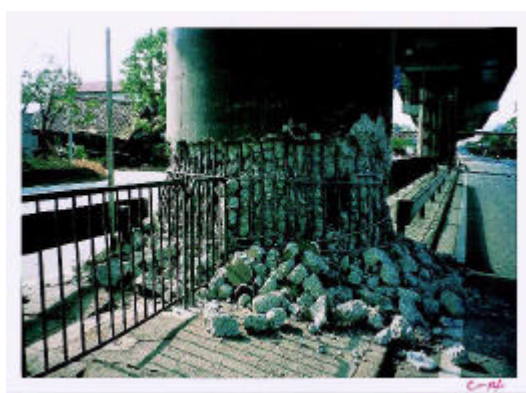
写真 4.4-1 曲げ被災の一例
