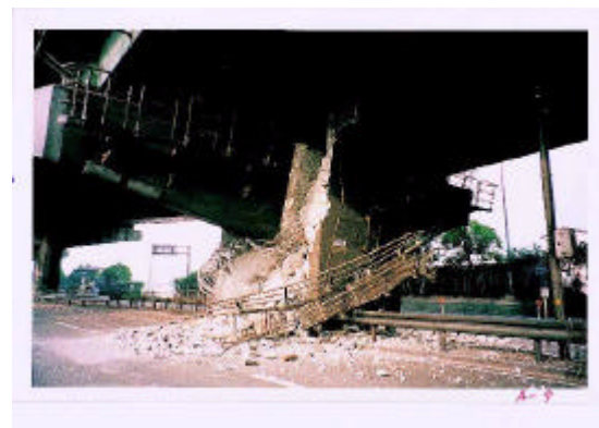
写真 4.4-2 せん断被災の一例
