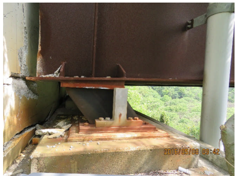
橋台上積層ゴム支承変形
