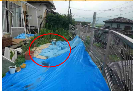
(b) 擁壁の上部宅地地盤の沈下(益城町)
