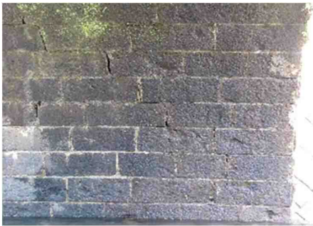
(a) 銭瓶橋の亀裂状況
