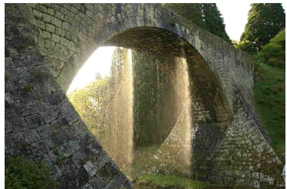
(b) 地震後のアーチ輪石からの漏水状況
