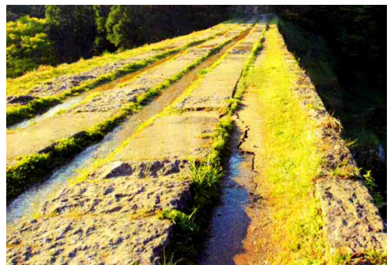
(d) 橋面上の亀裂の発生状況
