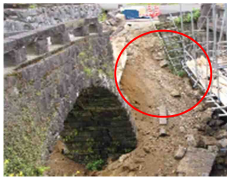
(b) 地震後の右岸側壁石崩壊状況
