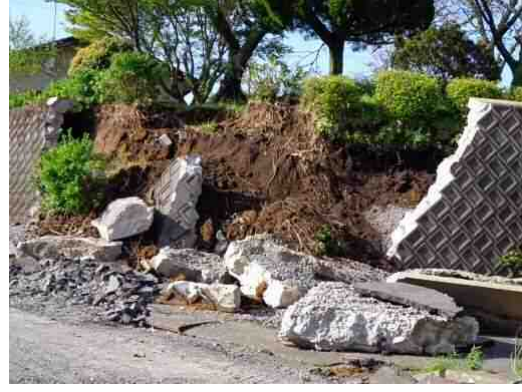
(f) 練石積擁壁の倒壊(南阿蘇村)
