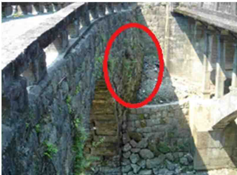
(a) 地震前右岸上流側壁石の孕み
