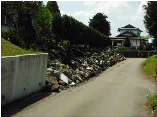
(g) 空石積擁壁の崩壊(西原町)
