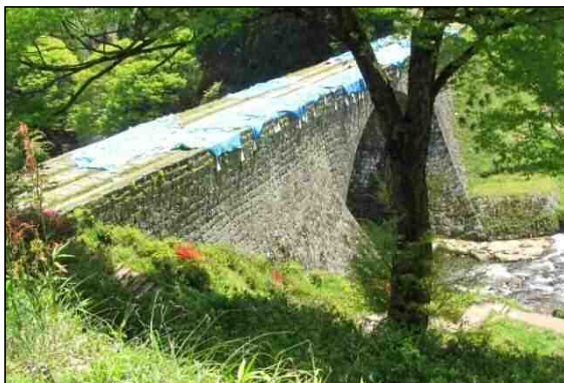
(c) 通潤橋の被災状況の全体
