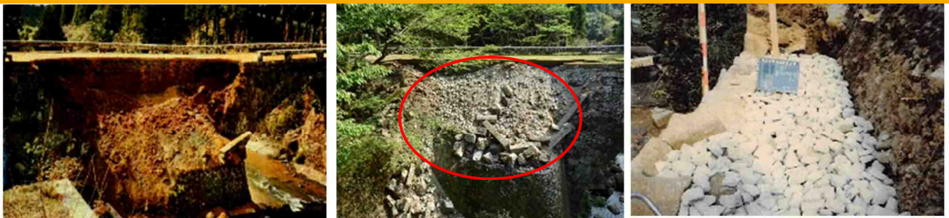
(a) 昭和 63 年の壁石崩壊
