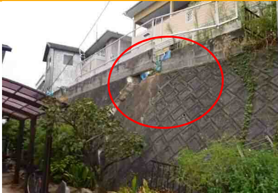
(a) 練石積擁壁の縦クラック(益城町)
