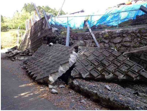
(e) 練石積擁壁の倒壊(西原町)
