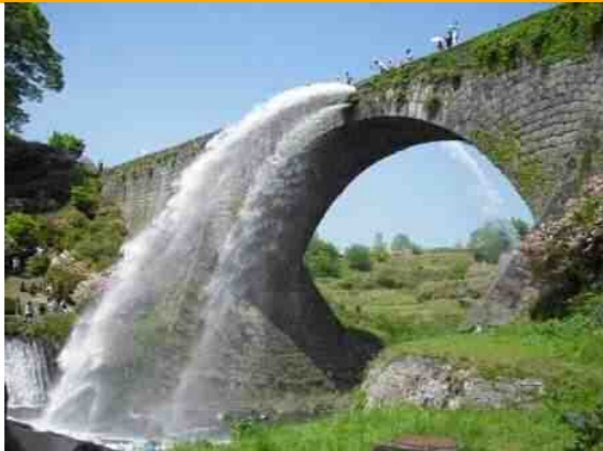
(a) 地震前の放水状況
