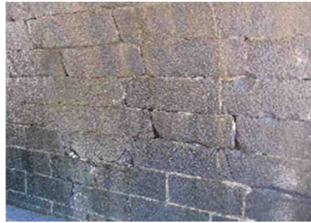
(b) 濁川橋の亀裂状況
