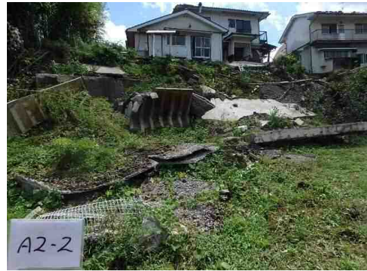
(h) L型擁壁の倒壊(南阿蘇村)
