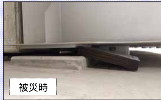
ゴム支承抜け出し
