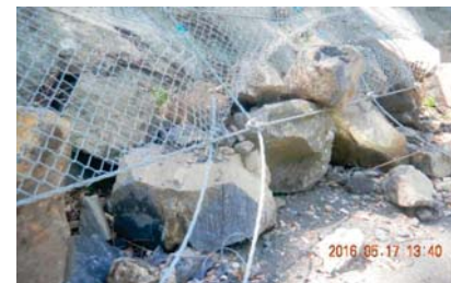
落石防護網による落石の捕捉 (下益城郡美里町 県道321号線)
