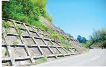
健全な状態を維持した吹付枠工 (マミコウロード)
