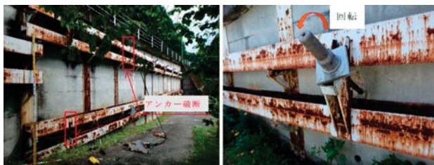
グラウンドアンカーの変状(破断・回転)
