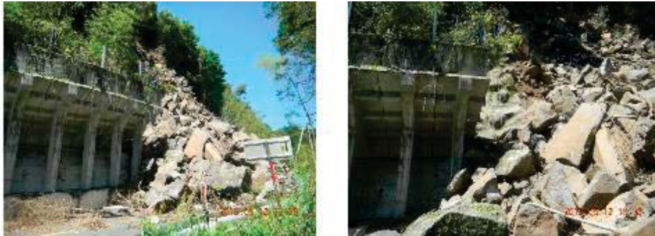
ロックキーパー側部岩盤崩壊(国道445号線下鶴地区)
