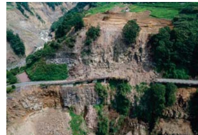
A地区の被災した吹き付け枠工
