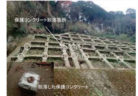
B地区の保護コンクリートが脱落したのり面
