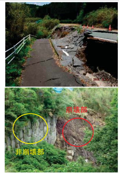
南阿蘇村河陽(県道149号)の道路と補強土壁の状況
