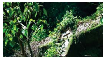
切土補強土(旧基準): 頭部コンクリート落下, 挿入鉄筋抜け出し. のり面安定性に影響無し. (迂回路: 県道219号)
