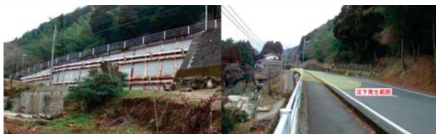
土留め擁壁の全景と路面の変状
