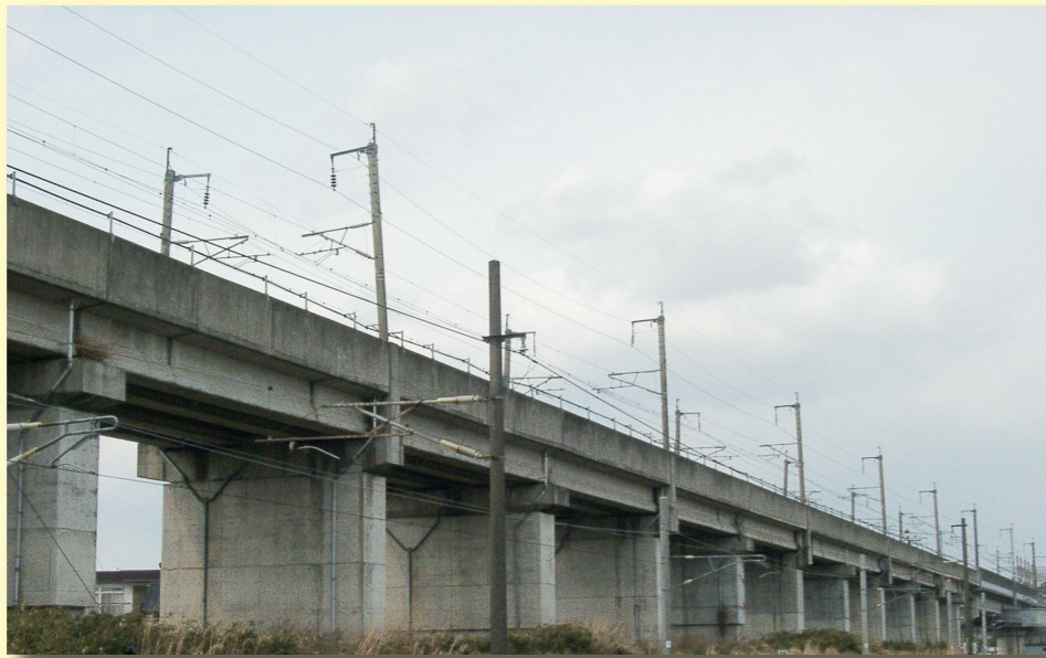
軽微な損傷にとどまった東北新幹線高架橋（福島県）
