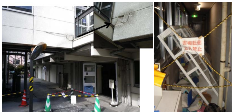
図 3：庁舎の被災状況
