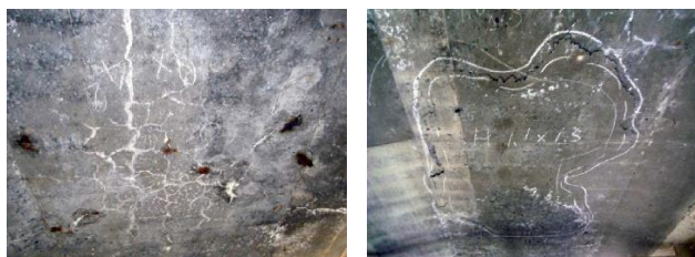
床版劣化状況（写真左：クラック，写真右：浮き）
