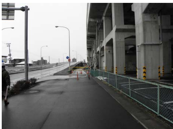
写真-3 新幹線高架橋の排水パイプの落下
