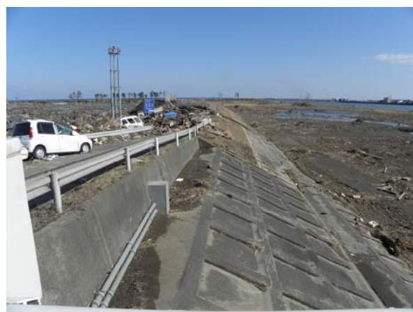
写真-16 閑上大橋付近の堤防の状況
