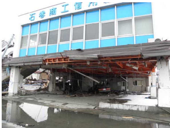
写真-7 鉄骨・RC構造物の損傷状況(その3)
