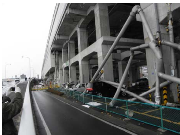
写真-4 排水パイプの落下による駐車車両の破損
