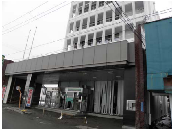
写真-5 鉄骨・RC構造物の損傷状況(その1)
