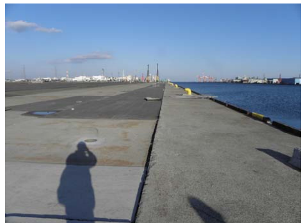
写真-22 仙台港の被災状況（その2）
