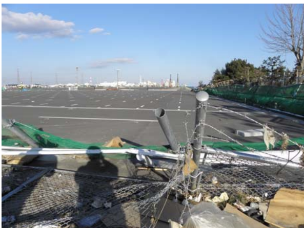
写真-21 仙台港の被災状況（その1）
