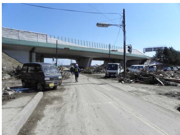
写真-13 仙台東部有料道路陸側の被災状況
