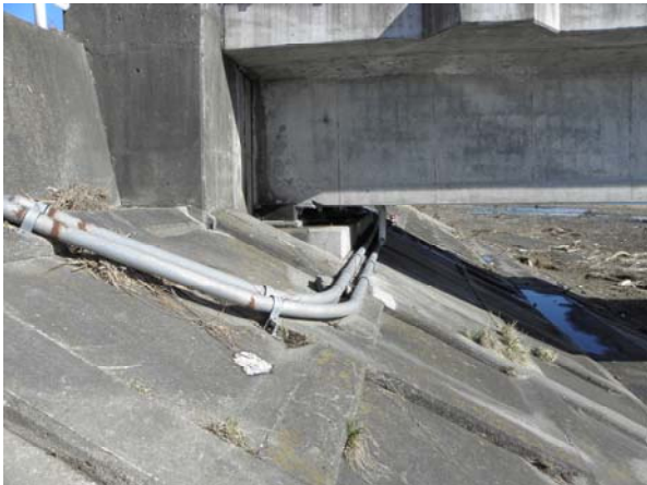
写真-17 関上大橋桁端部の損傷状況
