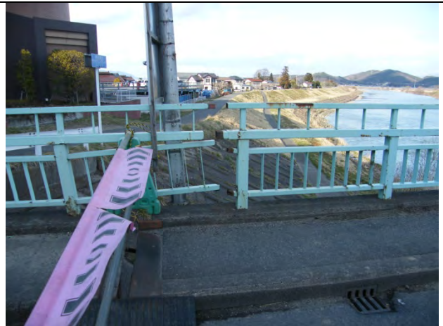
鎌田大橋 高欄の継目に空きがあり，橋台側の高欄が傾斜している。
