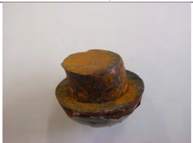
大黒橋 破断したリベットのサンプル
