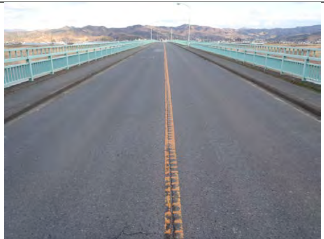
鎌田大橋 橋梁中心軸の移動（写真奥の黄線がずれている）
