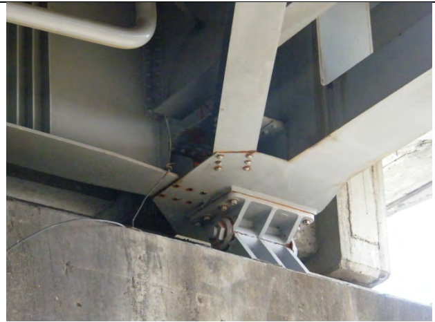
大黒橋 端床桁下フランジとガセットプレートの接合部の リベットが破断している。
