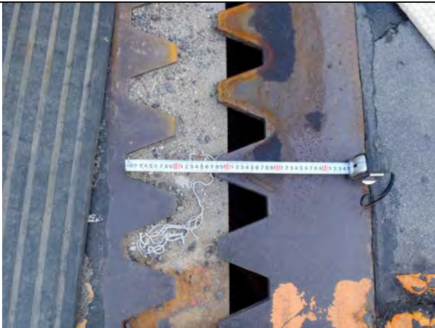
鎌田大橋 A1 橋台側伸縮装置の遊間異常（通常 50mm）
