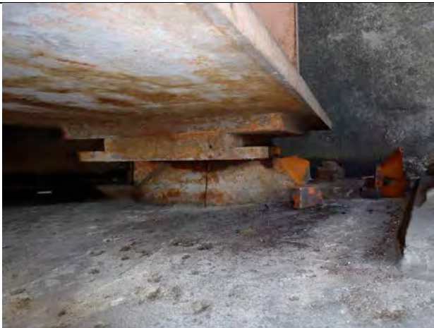
鎌田大橋 支承板支承サイドブロックの破断
