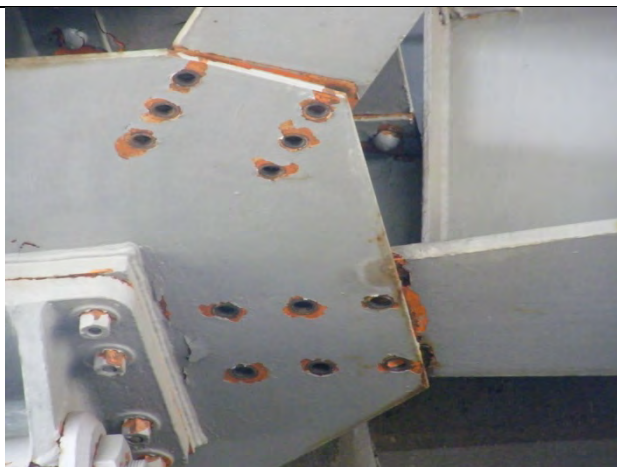
大黒橋 リベットが破断し、孔のみの状態である。
