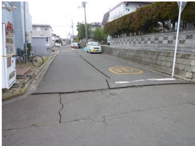
斜面直角方向の道路亀裂。下手(写真左側)に路面亀裂ならびに移動
