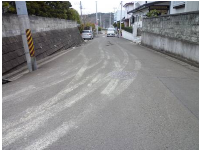
擁壁のブロックが下手にずれ、一部面外に孕む
