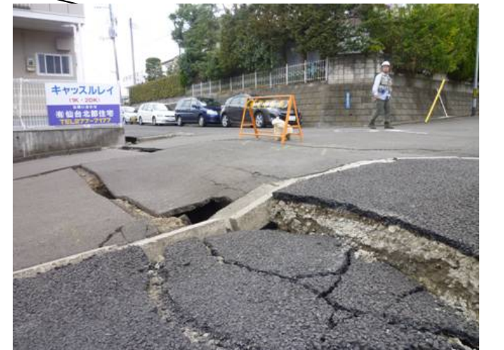
↑ 路面の亀裂。水道・下水管があり。ただし地表地盤には液状化の跡が確認できない。 ← 宅地擁壁の変状も伴い、門柱も傾斜
