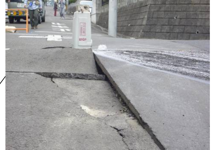
漏水箇所下手で路面の亀裂陥没。左側に下水管あり。
