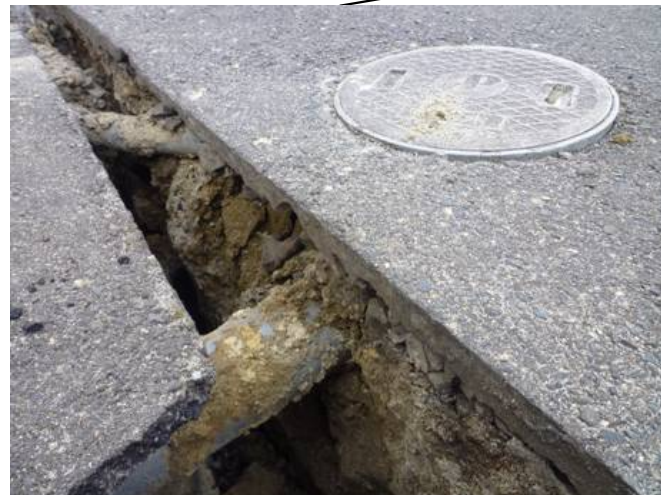
↑ 宅地内配管の露出。 → 通信ケーブルの露出。
