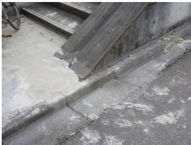
液状化の跡と見られる噴砂
