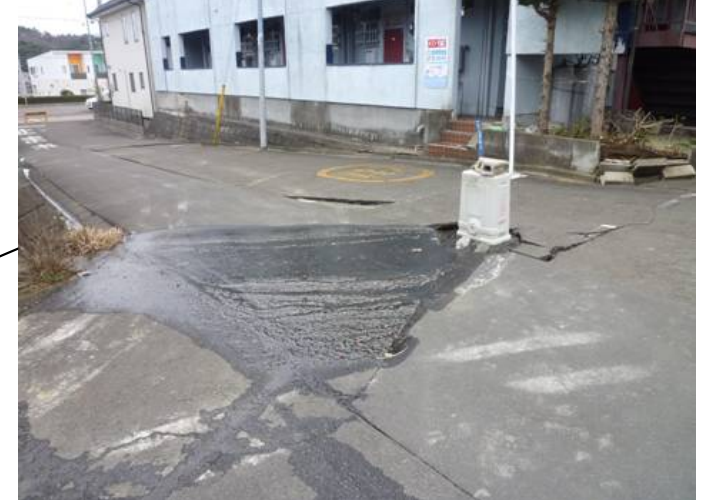
水道管の漏水
