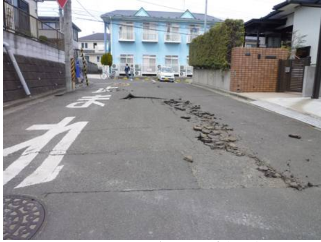
左側より移動し、路面に圧縮亀裂あり
