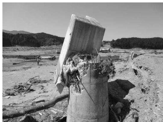
写真 4 津谷川橋梁の橋脚の破壊
