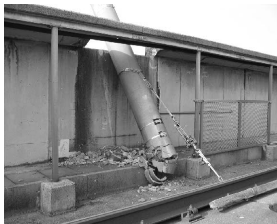
写真 2 電化柱の折損
