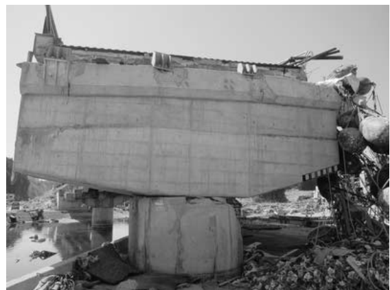
写真 3 歌津大橋の落橋防止装置の破壊
