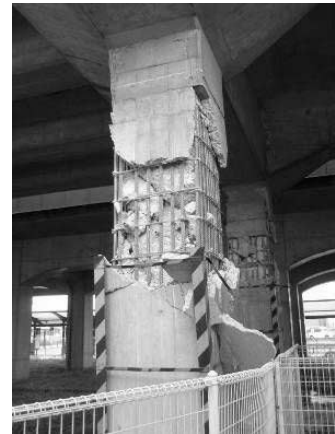
写真 1 柱の損傷状況
