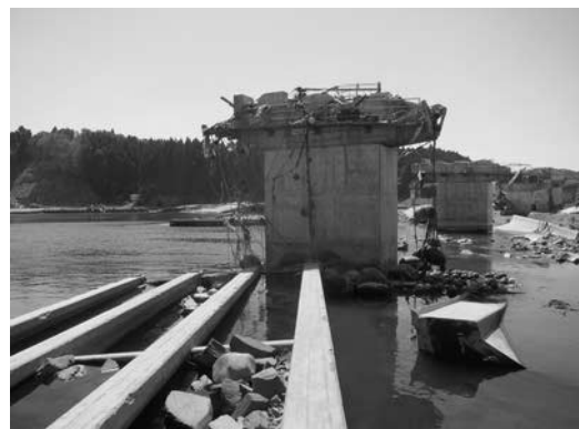
写真 2 歌津大橋の PC 桁の落橋
