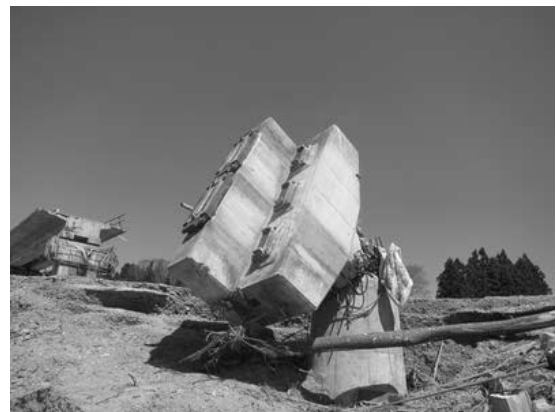
写真 2 津谷川橋梁の橋脚の被害
