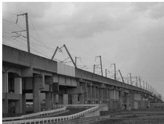
写真 1 東北新幹線の電化柱の損傷
