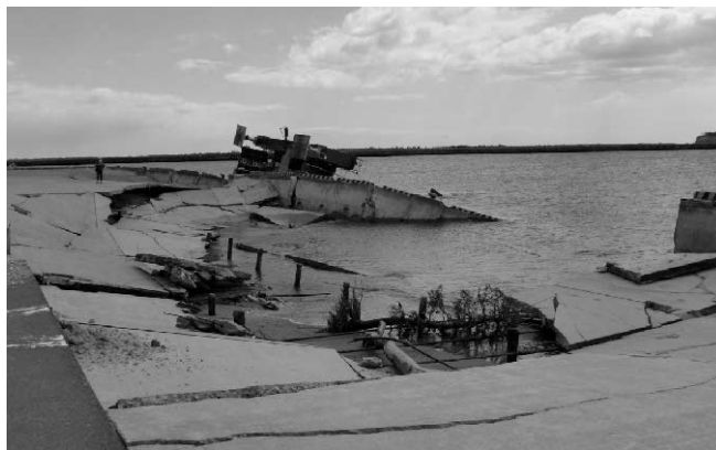
写真 1 液状化で破壊された岸壁（相馬港）
