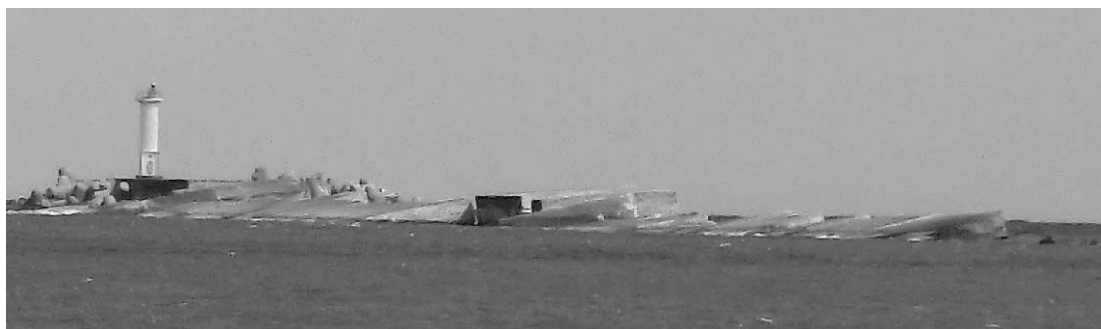
写真 3 不同沈下が生じた防波堤
