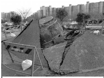
写真 1 浦安市の液状化被害 (小松美加氏撮影)
