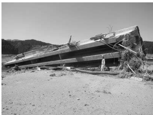
写真 3 津谷川橋梁の PC 桁の落橋
